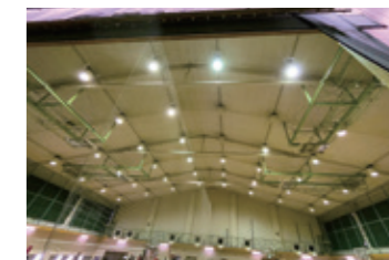
[体育館LED照明]
