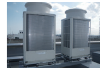
[空調インバータ室外機]
